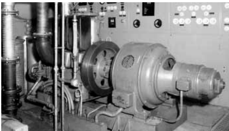
Der Maschinenraum mit der Notstromgruppe der Festung Fürigen wurde 1942 gebaut.
