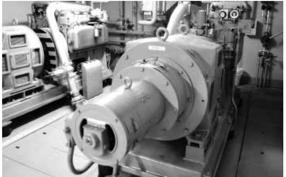
Während des Zweiten Weltkrieges war die Festung Crestawald nicht ans Ortsnetz des Rheinwalds angeschlossen. Die gesamte Elektrizität für den Betrieb der Anlage lieferten diese beiden 80 PS starken Sulzer-U-Boot-Motoren mit angeschlossenen Generatoren.
