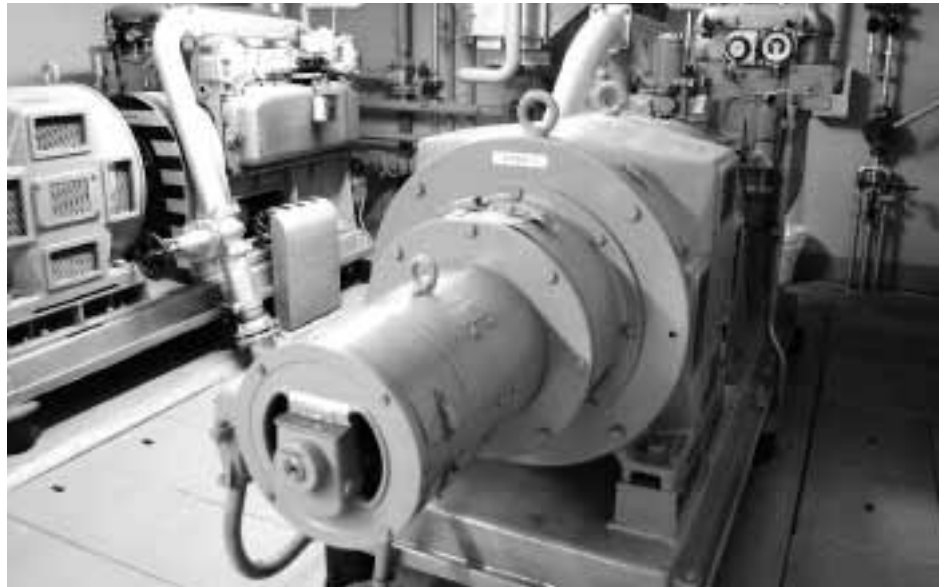
Während des Zweiten Weltkrieges war die Festung Crestawald nicht ans Ortsnetz des Rheinwalds angeschlossen. Die gesamte Elektrizität für den Betrieb der Anlage lieferten diese beiden 80 PS starken Sulzer-U-Boot-Motoren mit angeschlossenen Generatoren.
